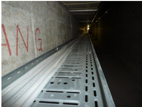
Parallel verlegte Leiter im Trasse Leitungslänge ca. 120m
